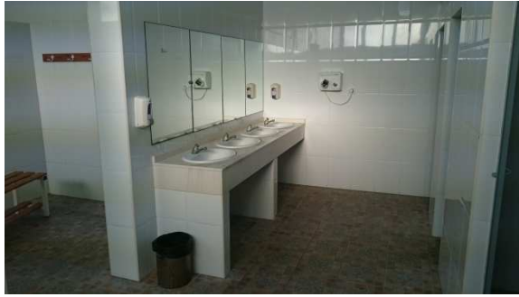
Imagen 43: Pilas situadas en frente de los lavabos.
