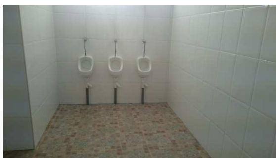
Imagen 41: Urinarios colocados a la izquierda de la entrada
