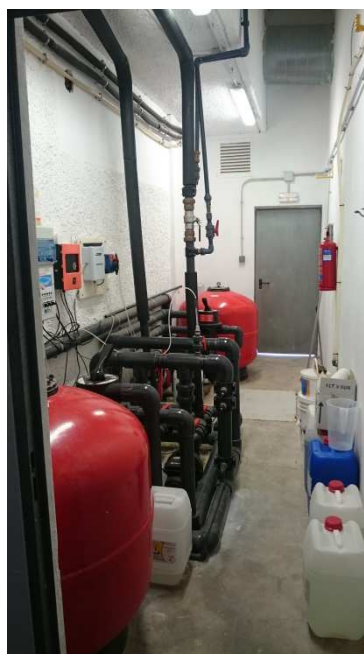
Imagen 48: Vista del interior de la sala de filtrado.
