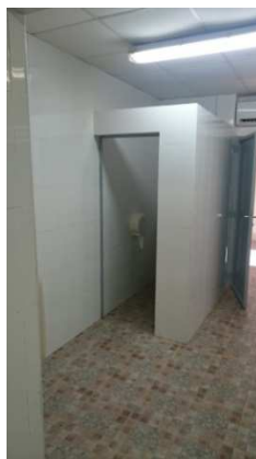
Imagen 21: Lavabo situado a la derecha de la entrada.
