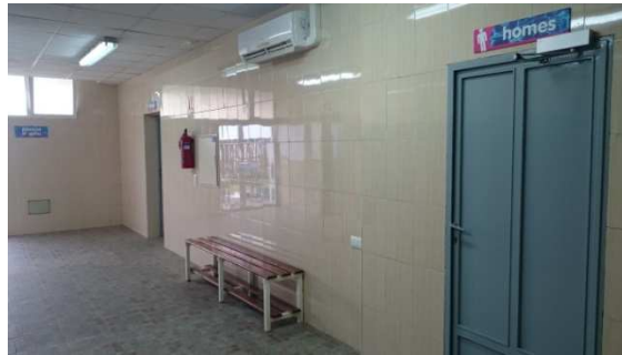
Imagen 18: Vista de la parte derecha donde se encuentran los vestuarios de chicos.
